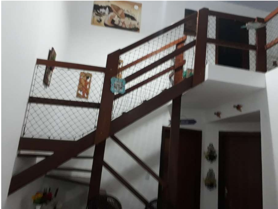
Tela de proteção na escada
